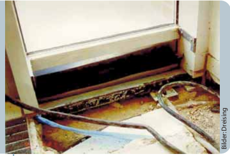
Fall 4: Kleine Ursache, große Wirkung – Regenwasser gelangte über die unten nicht fachgerecht eingedichteten Pfosten in die Konstruktion und in den Innenbereich.
