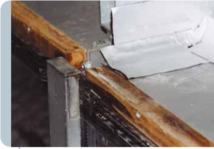
Fall 2: Die vertikalen Deckleisten der Fassade wurden oben geschlossen, so dass die Belüftung der Konstruktion nicht effektiv funktionierte.
