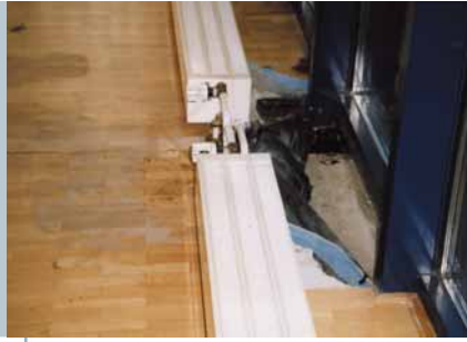
Fall 3: Unter den wasserführenden Pfostenprofilen war die Folie nicht durchgehend verlegt worden.
